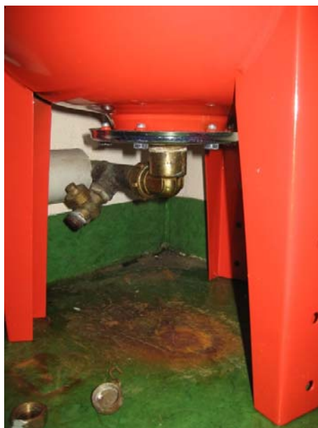
Fig. 7 Hydrofor i herrarnas omklädningsrum
