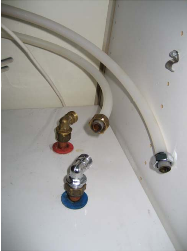
Fig. 14 Varmvattenberedare under diskho i kök.
