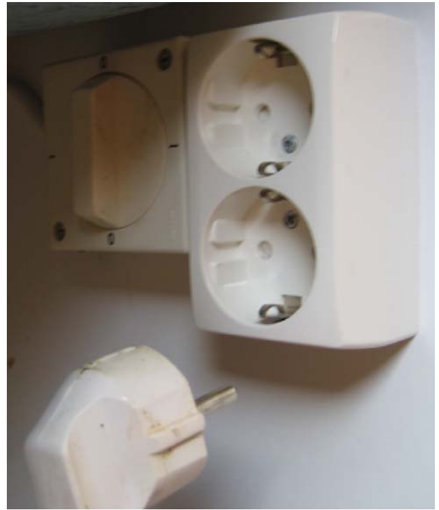
Fig. 15 Elkontakt till varmvattenberedare. Brytare i läge "0".
